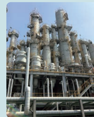
麥寮廠蒸餾塔
