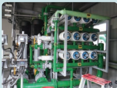
RO 逆滲透過濾系統
